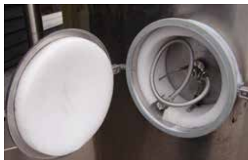
Endelig udgave af den fastmonterede prøveudtagningshane med isoleret kappe og dæksel.
