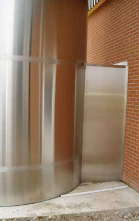
Silotank opstilles med alkove og direkte adgang til udløbsrør og mandeluge fra mælkerummet.
