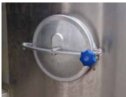
Prøveudtagningshanen sidder beskyttet og frostfrit bag det isolerede dæksel.
